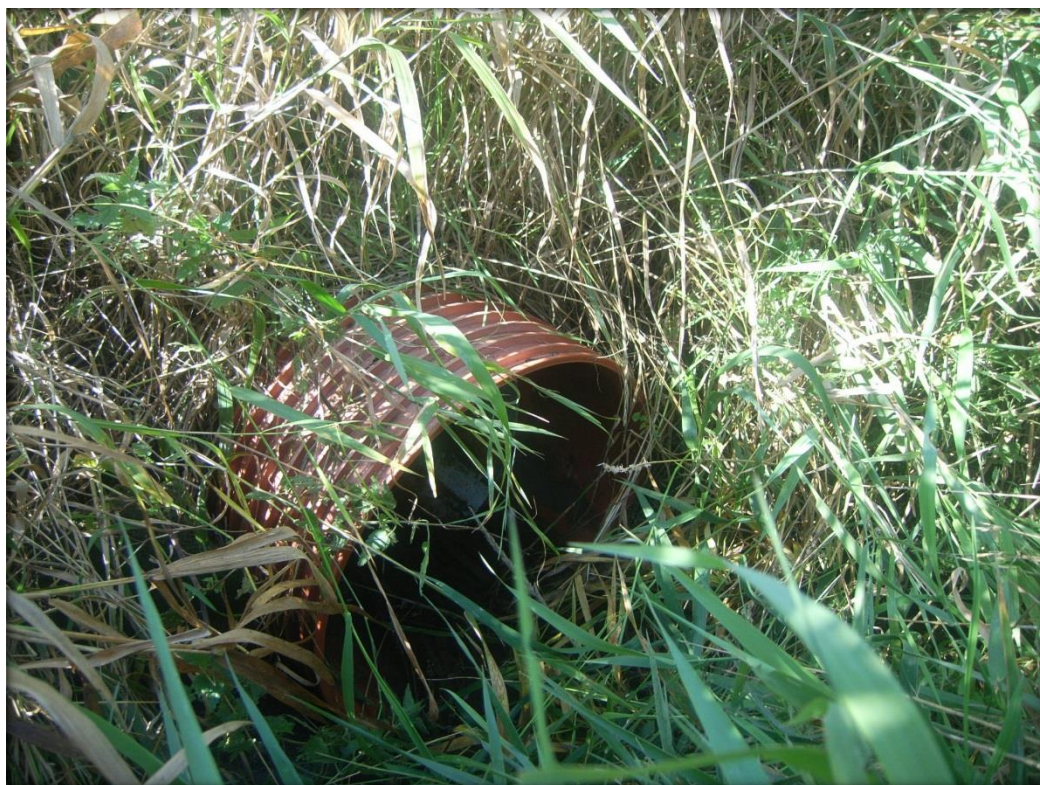
Figur 1.3 Indløb af rørledning AAL-1291.
